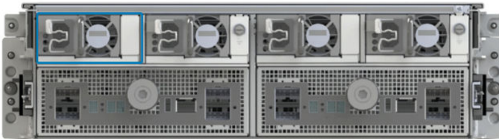
Рис. 7 Заменяемый источник питания В0 — пример расположения
