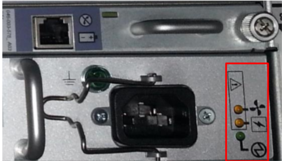
그림 113 전원 공급 장치 A 상태 표시등
