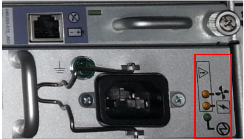
그림 122 전원 공급 장치 A 상태 표시등
