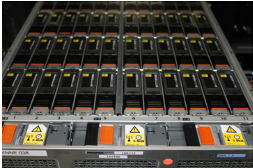
그림 116 디스크 엔클로저 내부의 팬 및 디스크 드라이브
