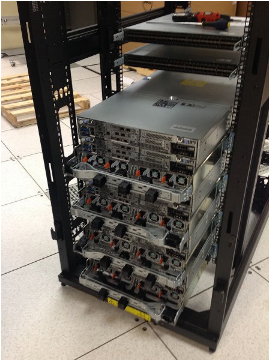
Figure 38 Vue arrière du serveur EX3000D dans le rack
