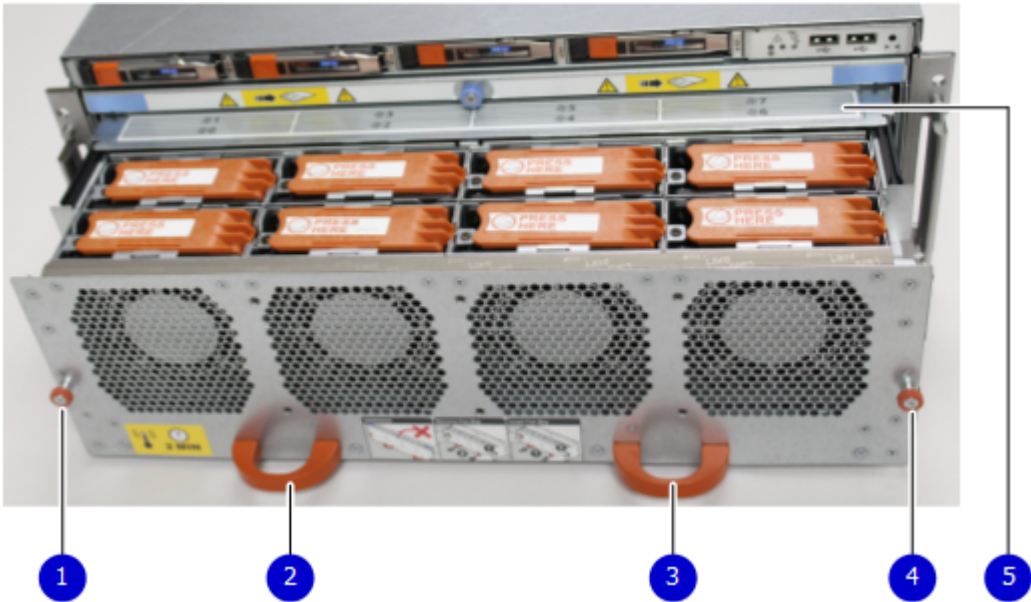
Figure 109 Unité de ventilation ouverte
