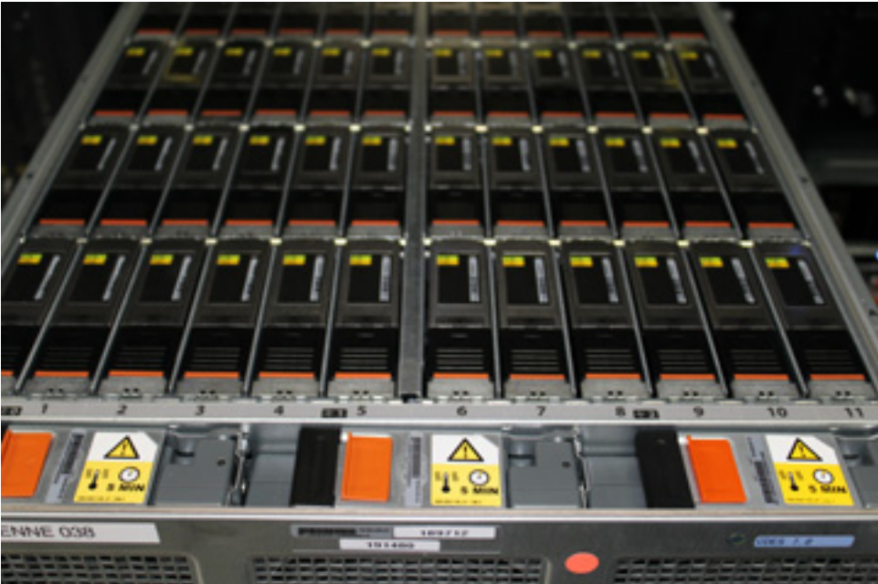
Figure 116 Ventilateurs et lecteurs de disques à l'intérieur du boîtier du disque
