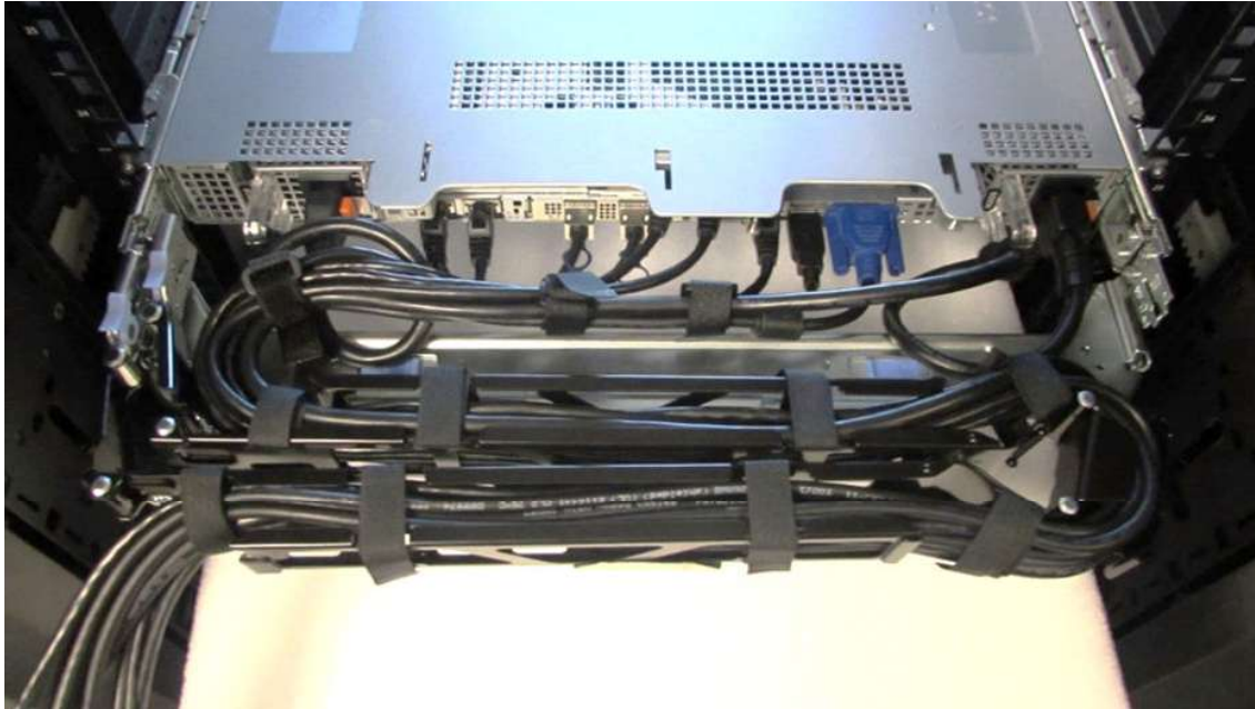
Ilustración 47. Cableado del CMA
